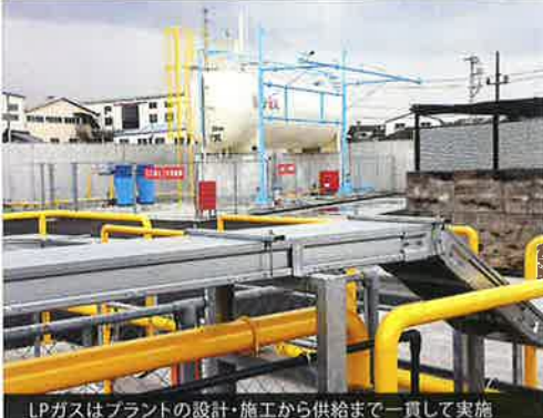
LPガスはプラントの設計・施工から供給まで一貫して実施
